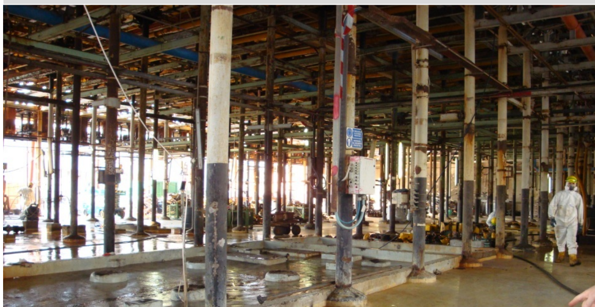
Plancher de la salle de cellule régulièrement arrosé
